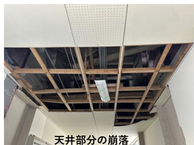
天井部分の崩落
