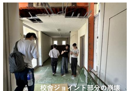
校舎ジョイント部分の崩壊
